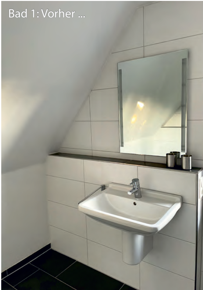
Bad 1: Renovierung nach jahrzehntelanger Nutzung
